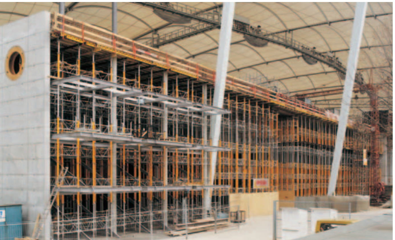
Siguran prijenos velikih opterećenja: 14,00 m visoka MULTIPROP nosiva skela na površini od 3.500 m 2 .
