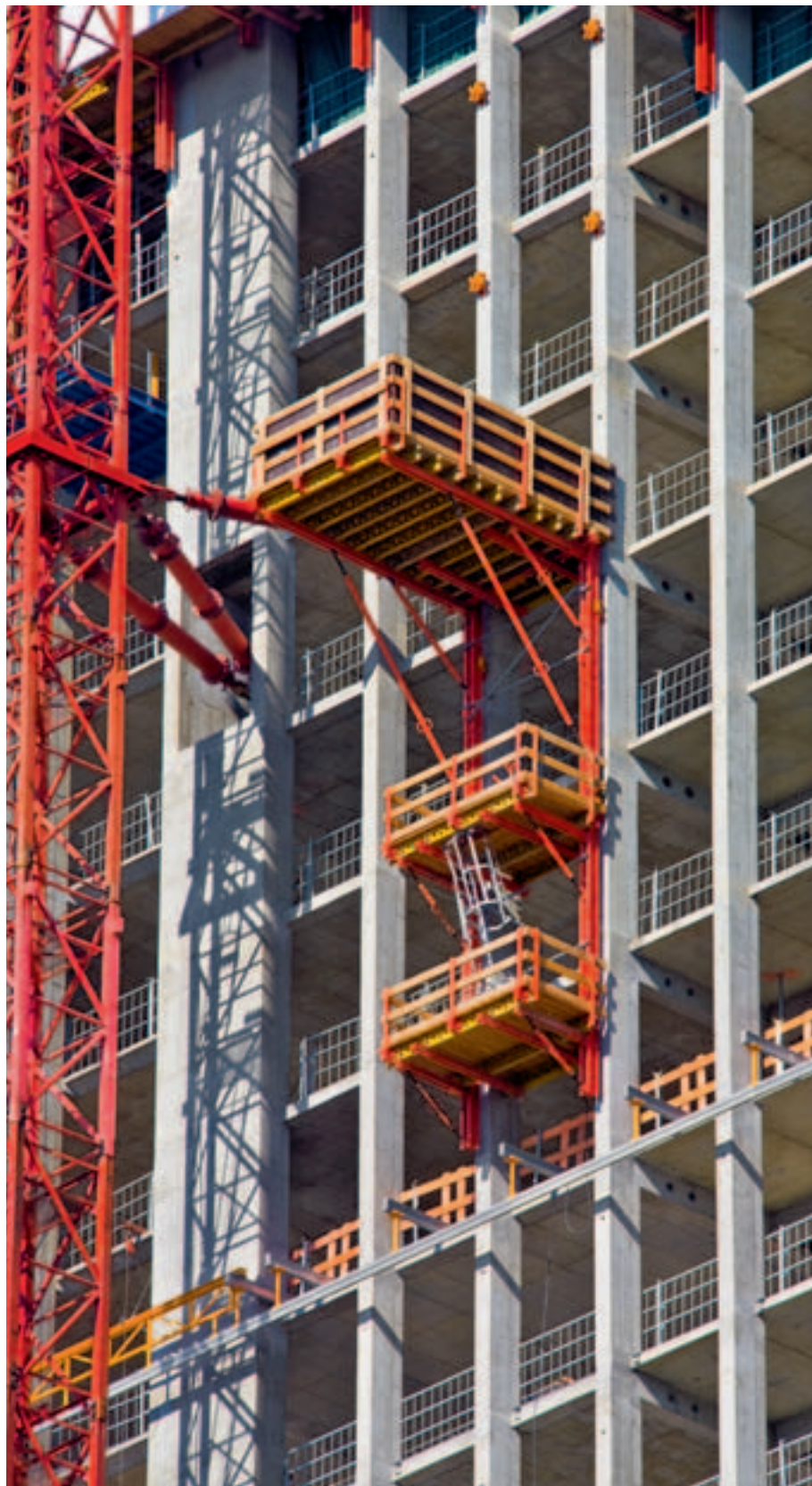
Samopenjaćuci RCS konzolni podest s 2 slijedna podesta na neboderu, sidren u podupiračima fasade.
