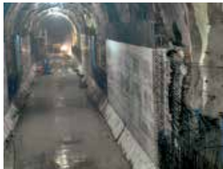
Najbolji rezultati betoniranja iz 2. takta (područje zida) čine izlaz za kolica za montažu luka.
