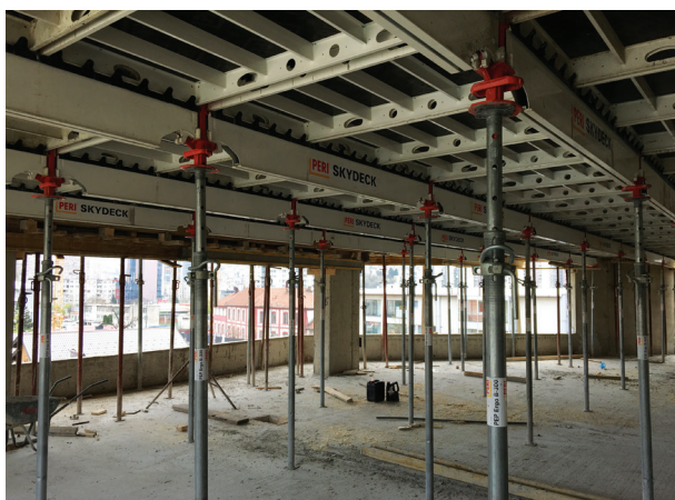
Primjena 650 m 2 SKYDECK stropne oplate na gradilištu SPO Dijamant, Sarajevo (DŽEKOS d.o.o. Sarajevo).
